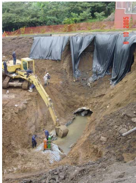
Fotografía 14. Localización de la tubería en el punto de colapso
