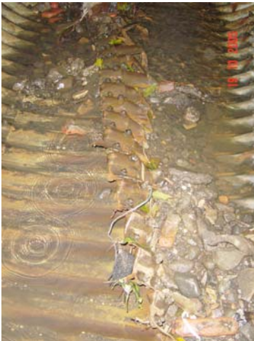
Fotografía 21. Falla en la base de la tubería, en la zona adyacente al tramo de colapso total
