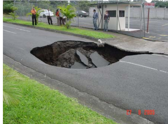
Fotografía 4. Punto superficial del colapso
