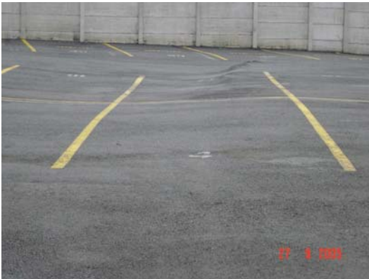
Fotografía 6. Deformaciones en el estacionamiento
