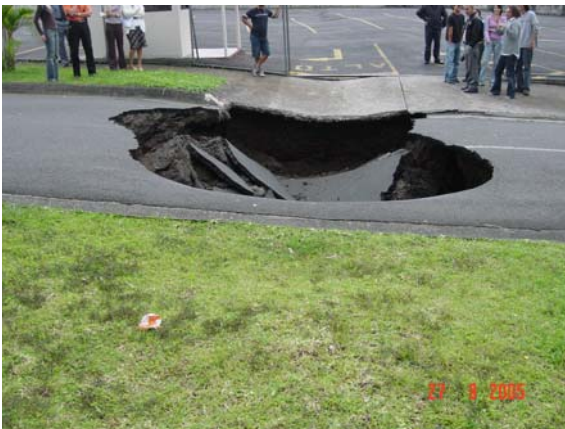
Fotografía 3. Punto superficial del colapso
