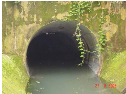
Fotografía 8. Punto de captación aguas arriba del punto de colapso
