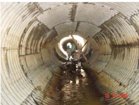
Fotografía 22. Deformación de la estructura de arco
