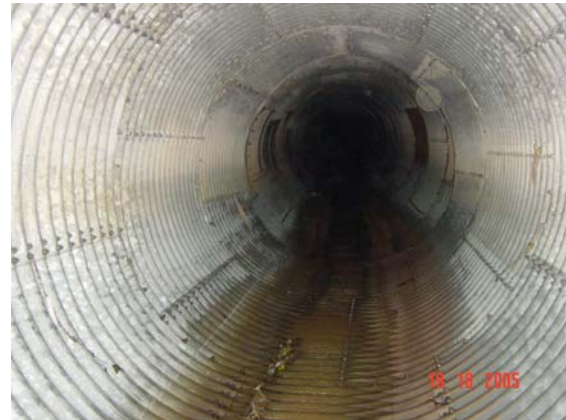
Fotografía 23. 20m aguas abajo del tramo colapsado
