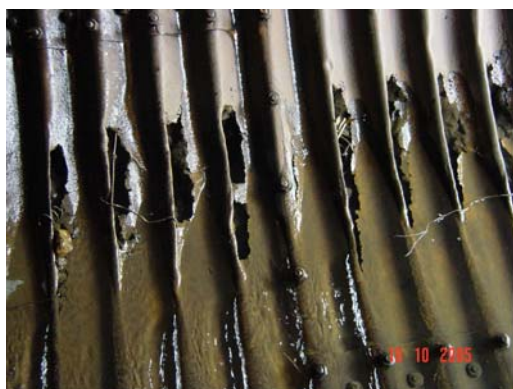
Fotografía 26. Deterioro en la base
