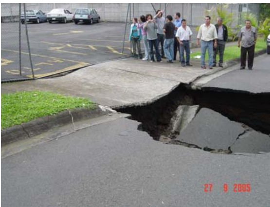
Fotografía 7. Punto superficial del colapso
