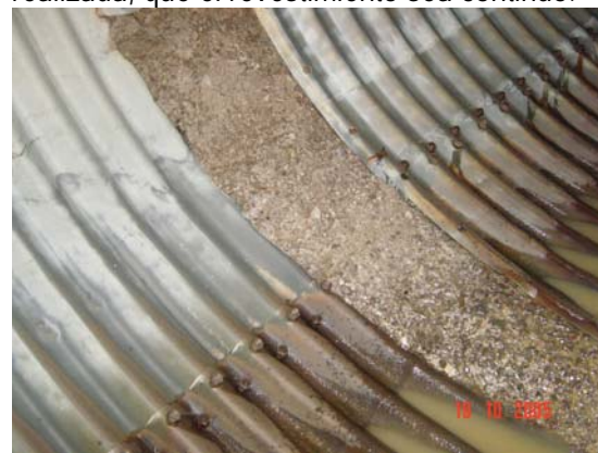
Fotografía 24. Punto de incremento en el diámetro de la tubería.
