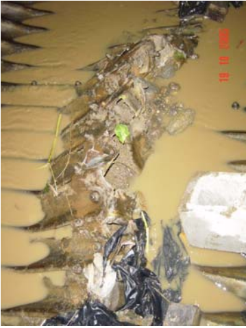
Fotografía 20. Falla en la base de la tubería, en la zona adyacente al tramo de colapso total
