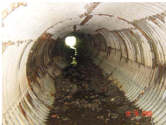
Fotografía 25. Tubería aguas arriba del tramo colapsado.
